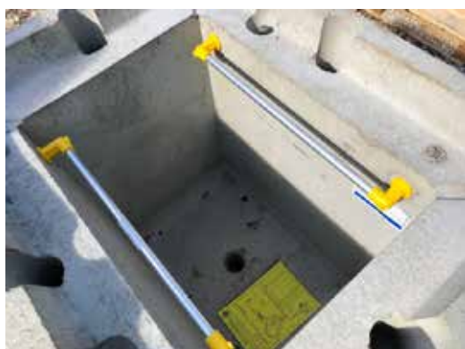
Chambre Telecom L1T avec supports d'équerres Caswick. Le parallélisme est parfait
